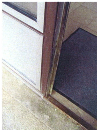
Hiányzó tömítés, belső korrózióra utaló rozsdafoltosodás
